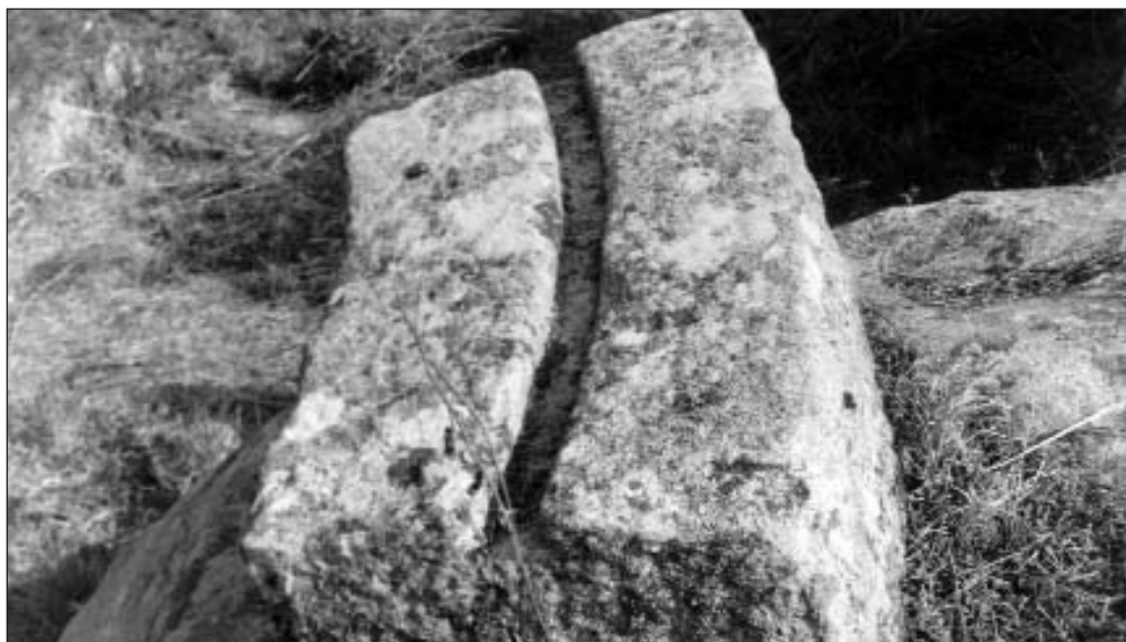
O muíño de Navia, exterior. Pedra pertencente ao remate superior da torre. Pódese ver a canaleta pola que rodaban as rodas do mecanismo que posibilitaba o movemento da cuberta para orienta-las aspas según a dirección do vento.
